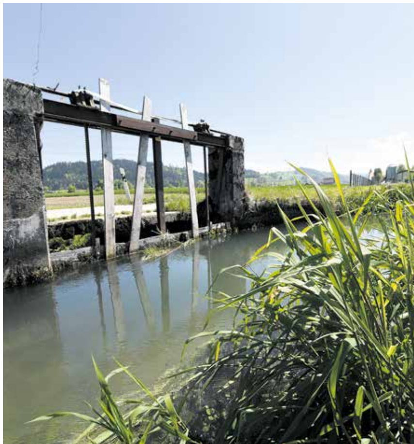
Wehranlage zur Wasserregulierung Burgrain. Foto zvg
